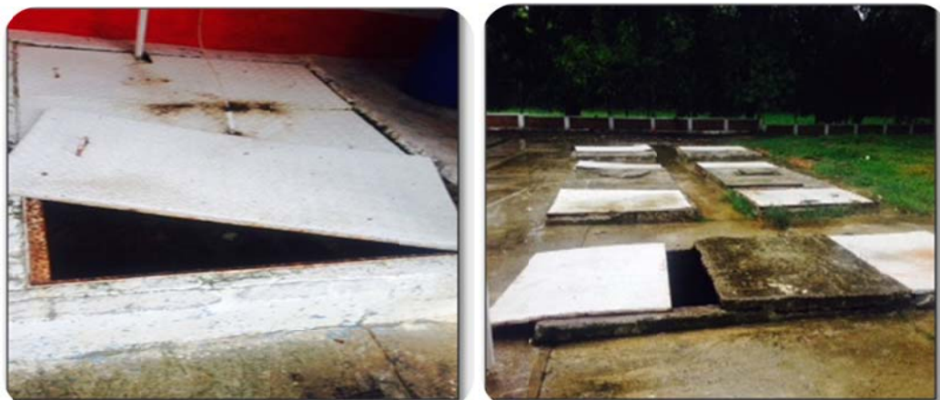
Fotografía 31 y 32 Sistema de tratamiento de aguas residuales
