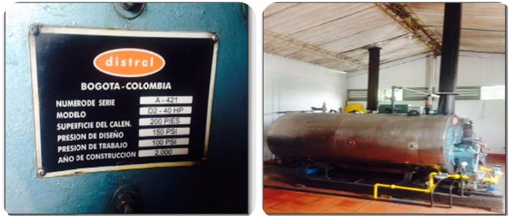
Fotografía 23 y 24 Caldera en funcionamiento
