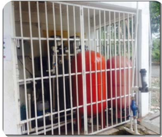
Fotografía 16 Sistema de tratamiento de agua potable
