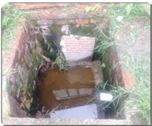
Fotografía 19 Caja de inspección conectada al sistema de alcantarillado del municipio
