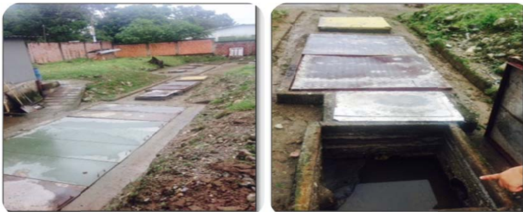
Fotografía 17 y 18 Sistema de tratamiento de aguas residuales
