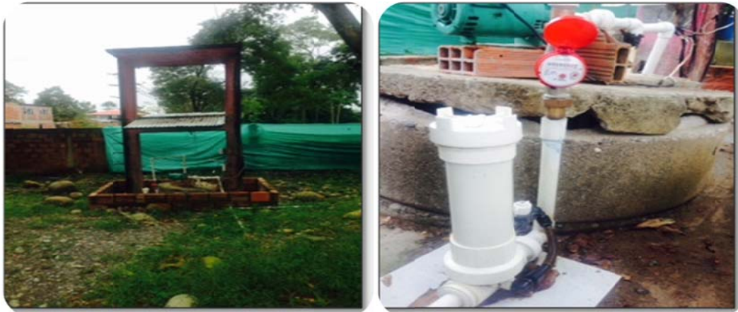
Fotografía 14 y 15 Pozos con sistema de medición de consumo de agua
